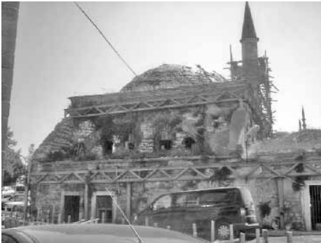
Şekil 2 Restorasyondan önceki durum ve çatlak rölövesi
