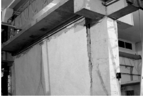
%1.75 - dış duvarın düzlemdışı doğrultuda stabilite kaybı.
