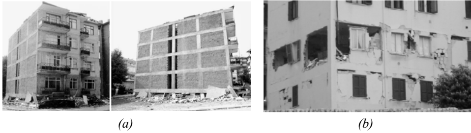
Şekil 1. (a) 1999 Kocaeli [3], (b) 2009 L'Aquila depremleri yumuşak kat hasarları [4].
